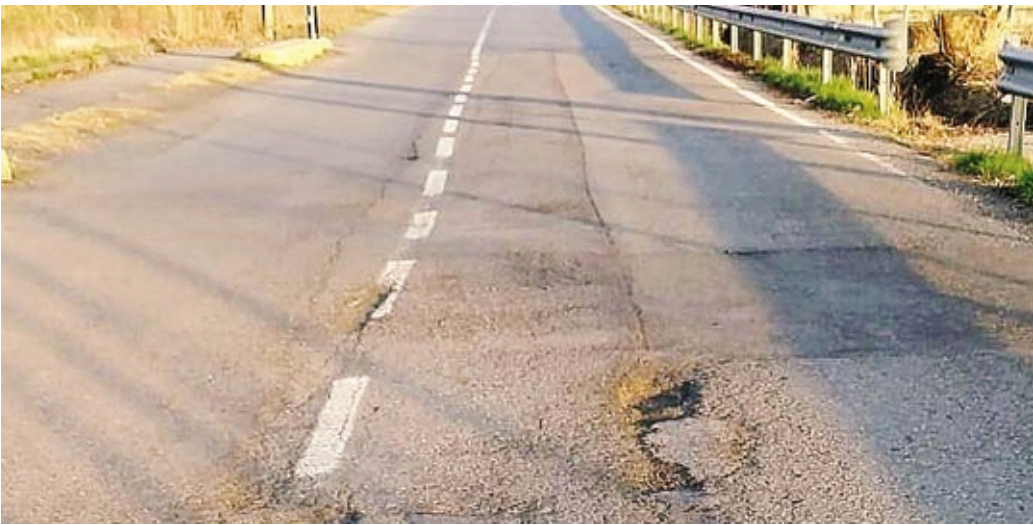
La provinciale 107 che porta dalla frazione di Villanuova alla frazione di Torre: uno dei tratti da riasfaltare
